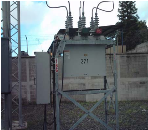
Figura 15. Recloser en aceite No. 271 del circuito No. 166 de la subestación Tinco
