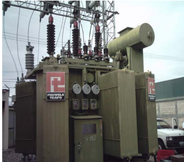
Figura 11. Transformador de potencia trifásico S-152 Subestación Ciudad Vieja
