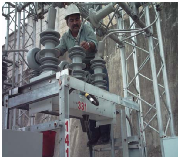
Figura 16. Recloser a gas No. 331 del circuito No. 141 de la subestación Luis Fernando Nimatuj
