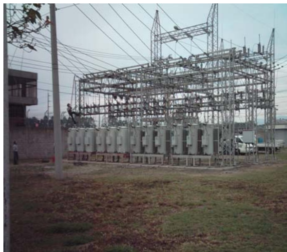
Figura 19. Bancos de reguladores de voltaje de los circuitos 126;127;128 y 129 de la subestación Aurora.
