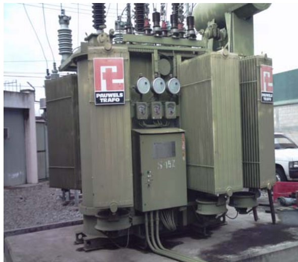
Figura 10. Transformador trifásico de potencia S-152 Subestación Ciudad Vieja
