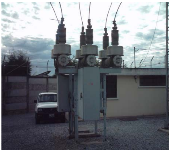
Figura 4. Interruptor de Potencia a gas: IG No. 44 Subestación Monte Cristo.
