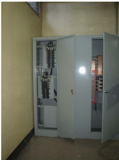
Figura 32. Tableros e interruptores termomagnéticos antes de alimentarlos
