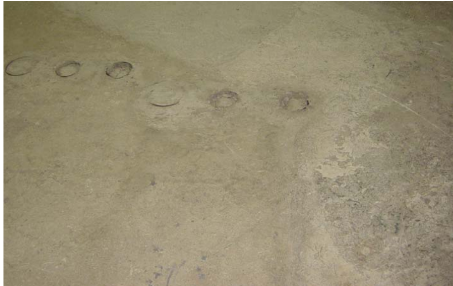
Figura 60. Área donde se encontraba la entrada de cables y medición desde el transformador
