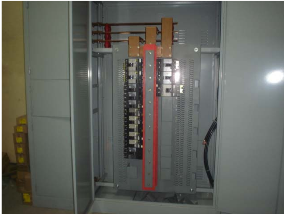
Figura 37. Interruptores termomagnéticos de caja moldeada en un gabinete I-Line
