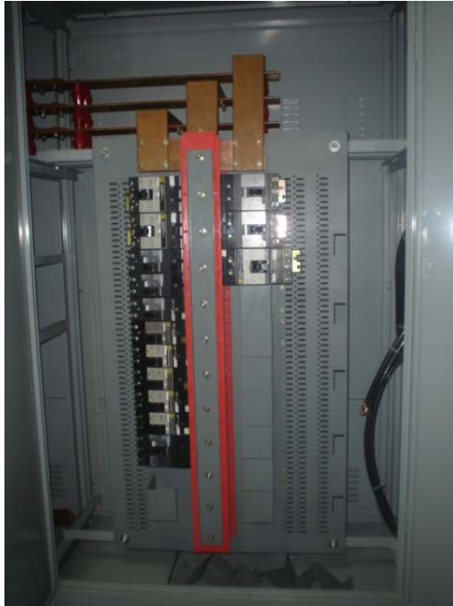
Figura 41. Interruptores termomagnéticos I-Line sin carga instalada
