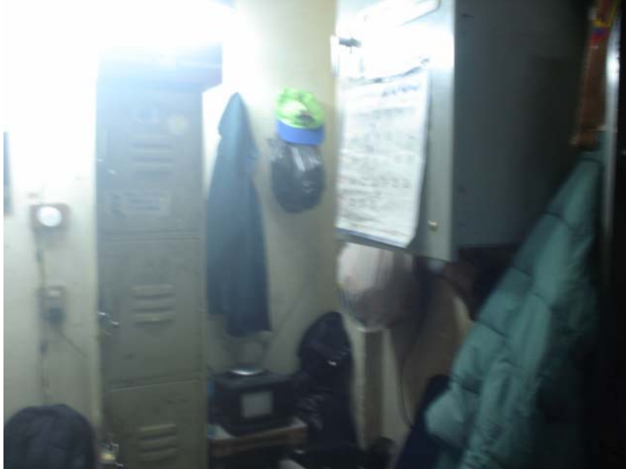
Figura 1. Área de estar del personal de mantenimiento en donde se encuentran los tableros eléctricos
