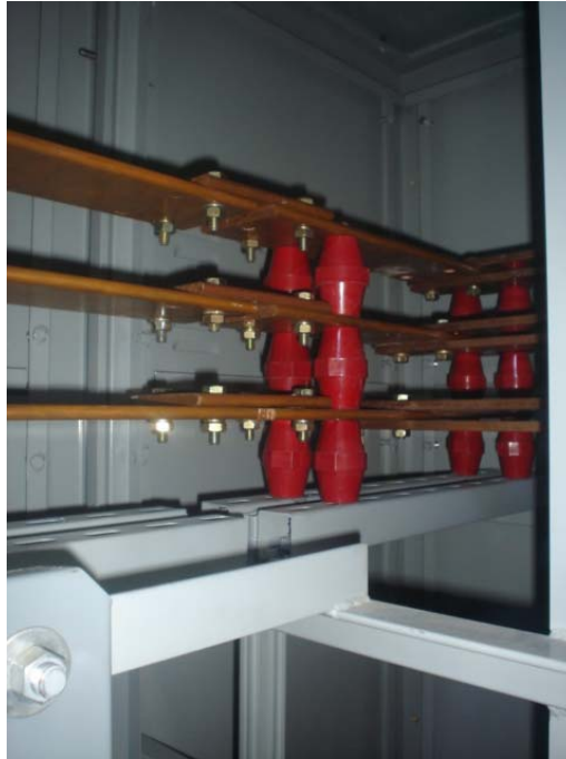
Figura 42. Barras separadas por aisladores de poliéster
