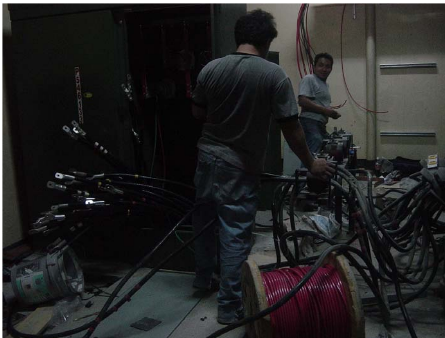
Figura 49. Alimentación del interruptor principal de la Municipalidad de Guatemala
