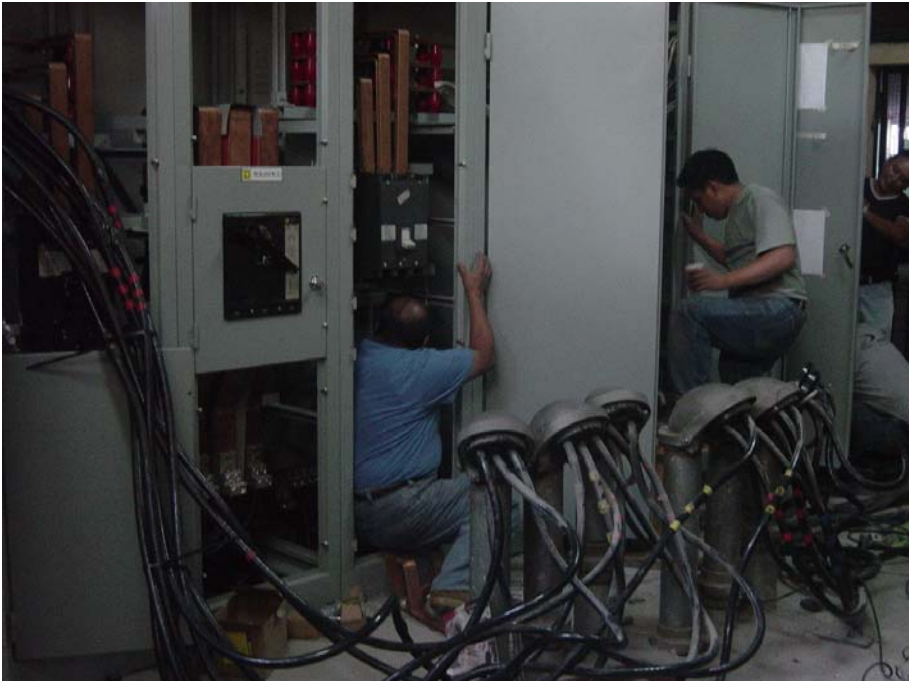
Figura 51. Alimentación desde el interruptor principal de EMPAGUA a barras
