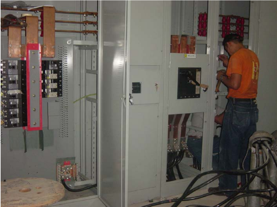
Figura 50. Alimentación del interruptor principal de EMPAGUA
