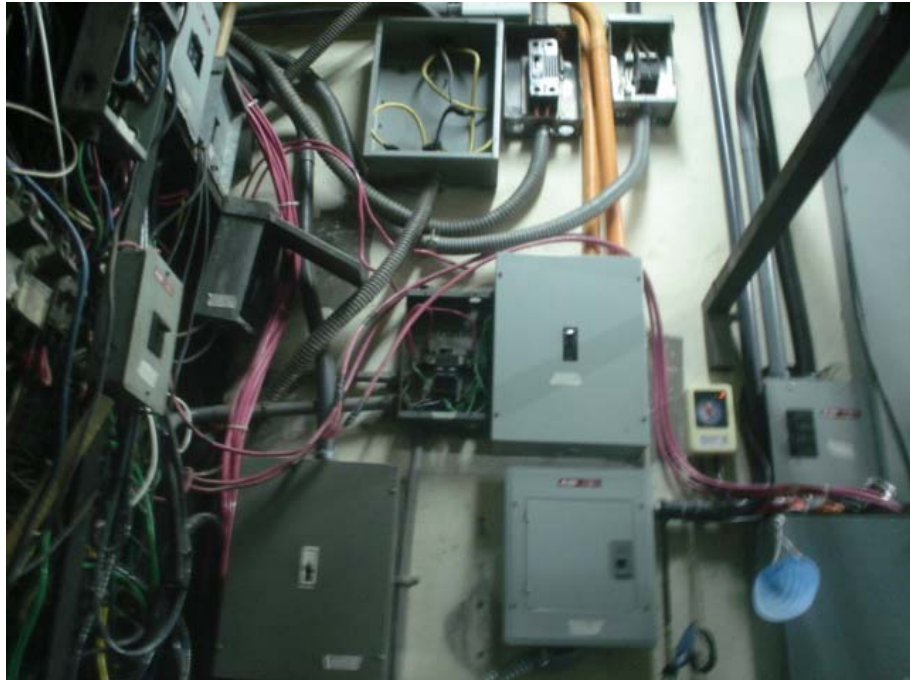
Figura 7. Tubería, cables y tableros existentes en área de estar del personal de mantenimiento
