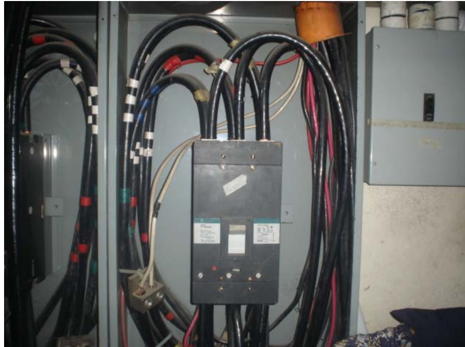
Figura 19. Interruptor termomagnético principal de la Municipalidad de Guatemala
