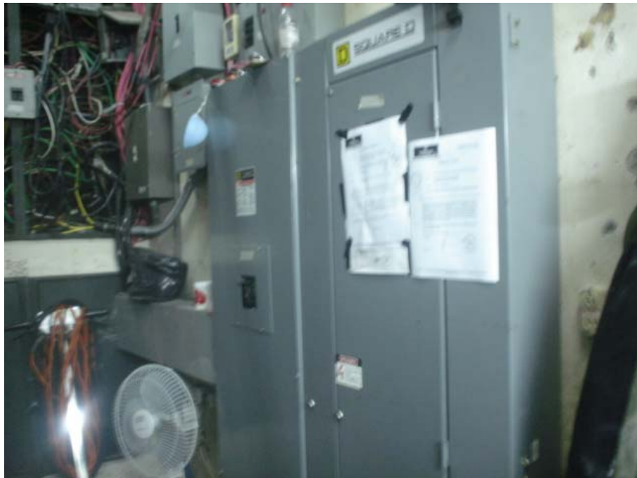
Figura 2. Bodega juntamente en área de tableros eléctricos
