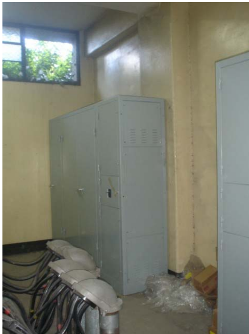
Figura 31. Tableros tipo gabinete antes de alimentarlos
