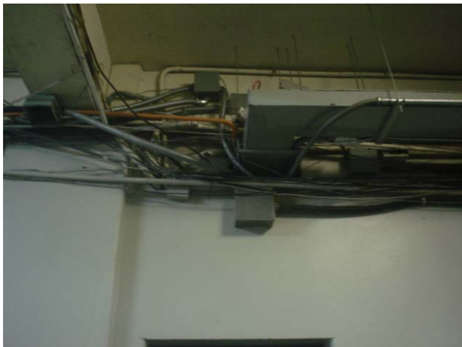
Figura 3. Tubería de agua mezclada con tubería eléctrica
