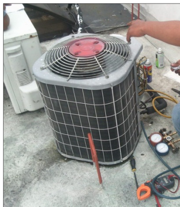
Figura 22. Instalación en la azotea
