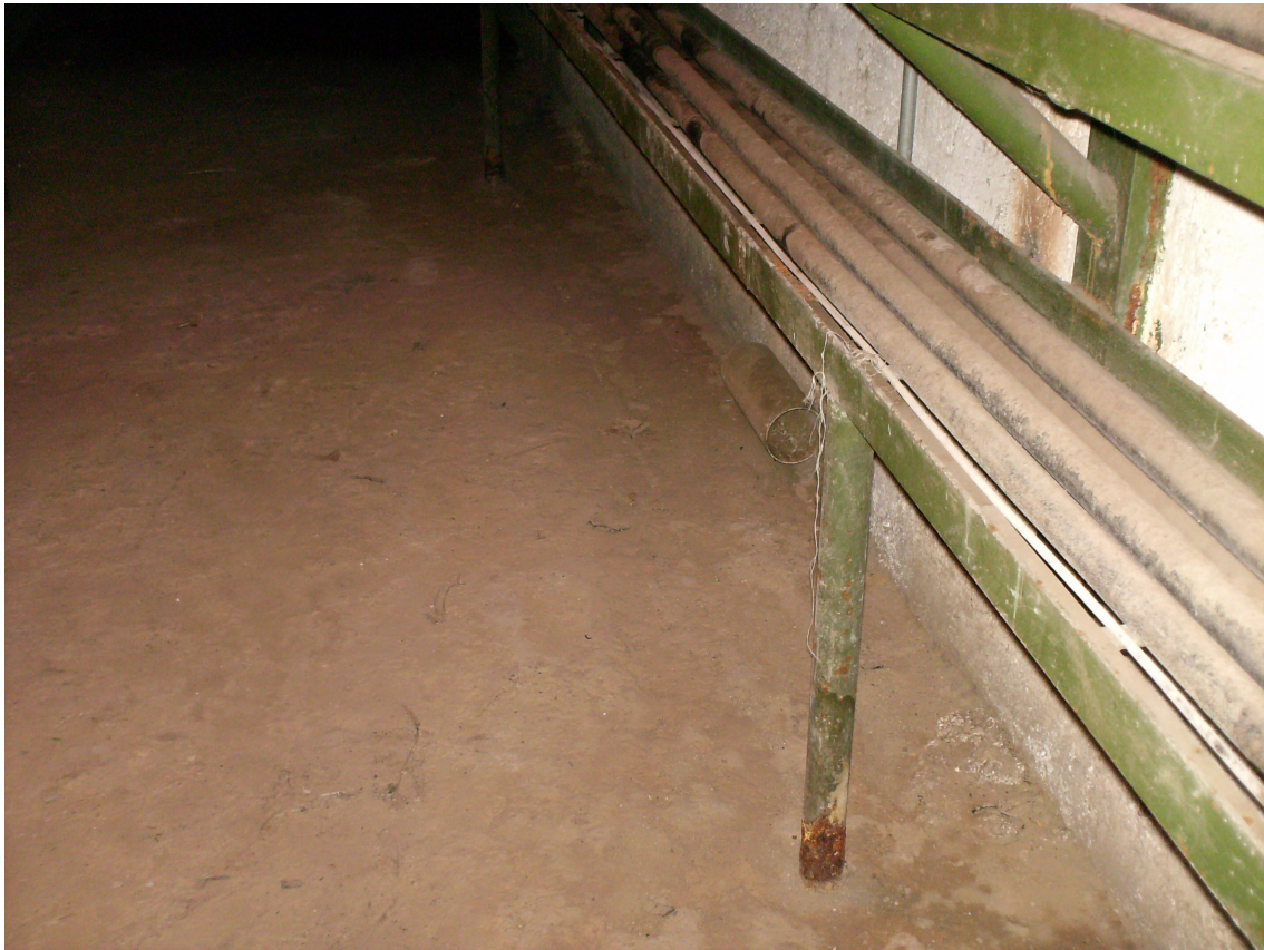
Figura 16. Canaletas en ducto subterráneo
