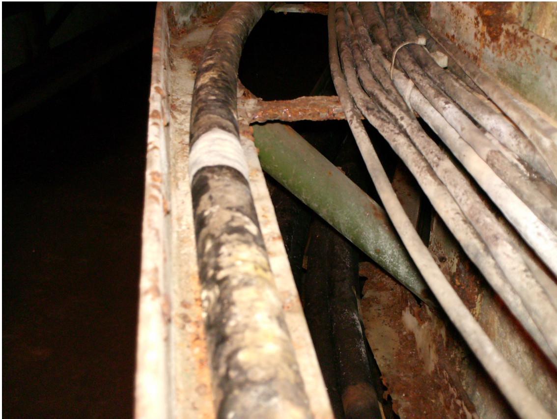
Figura 21. Cable de potencia
