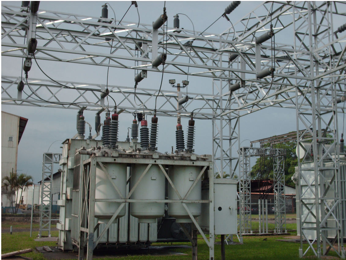
Figura 4. Interruptor transformador 32 MVA y seccionadores de aislamiento
