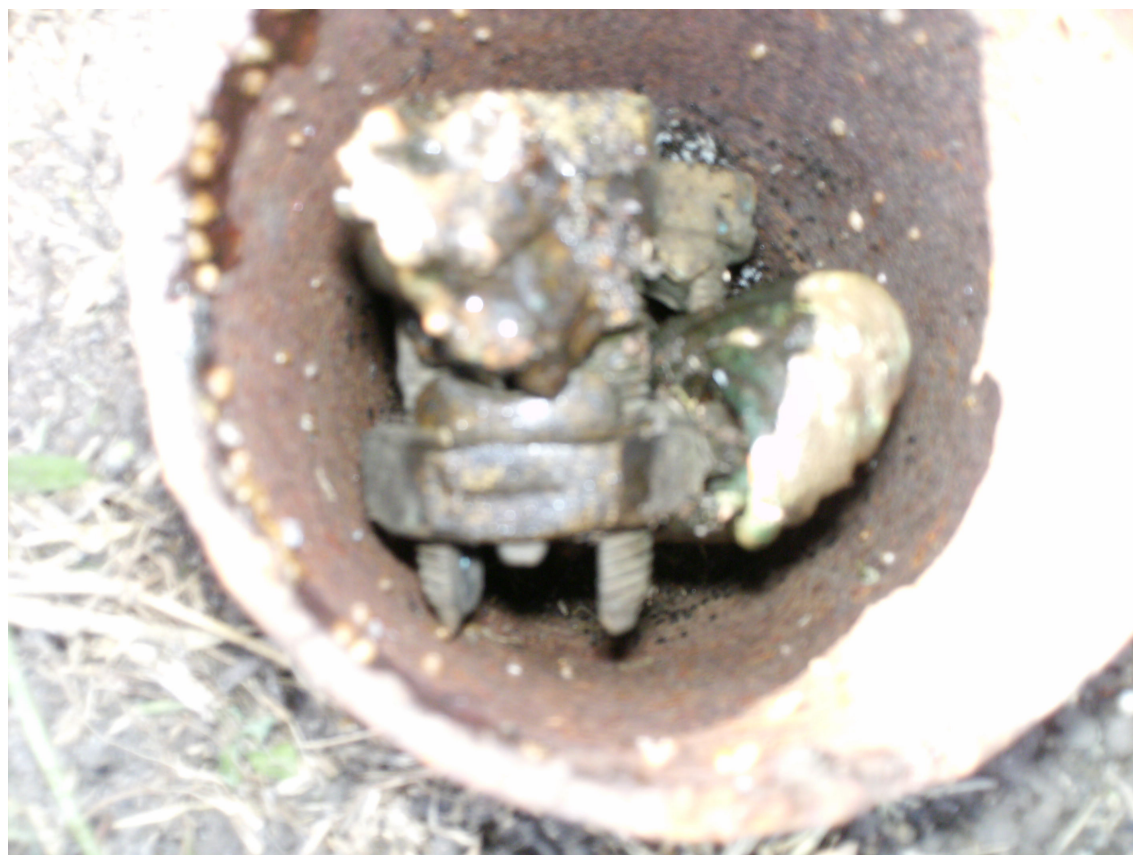
Figura 11. Descripción de tierras S/E 69 KV
