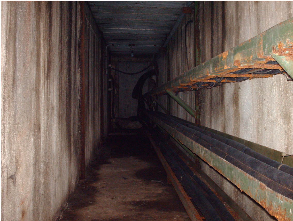
Figura 19. Canaletas en ducto subterráneo
