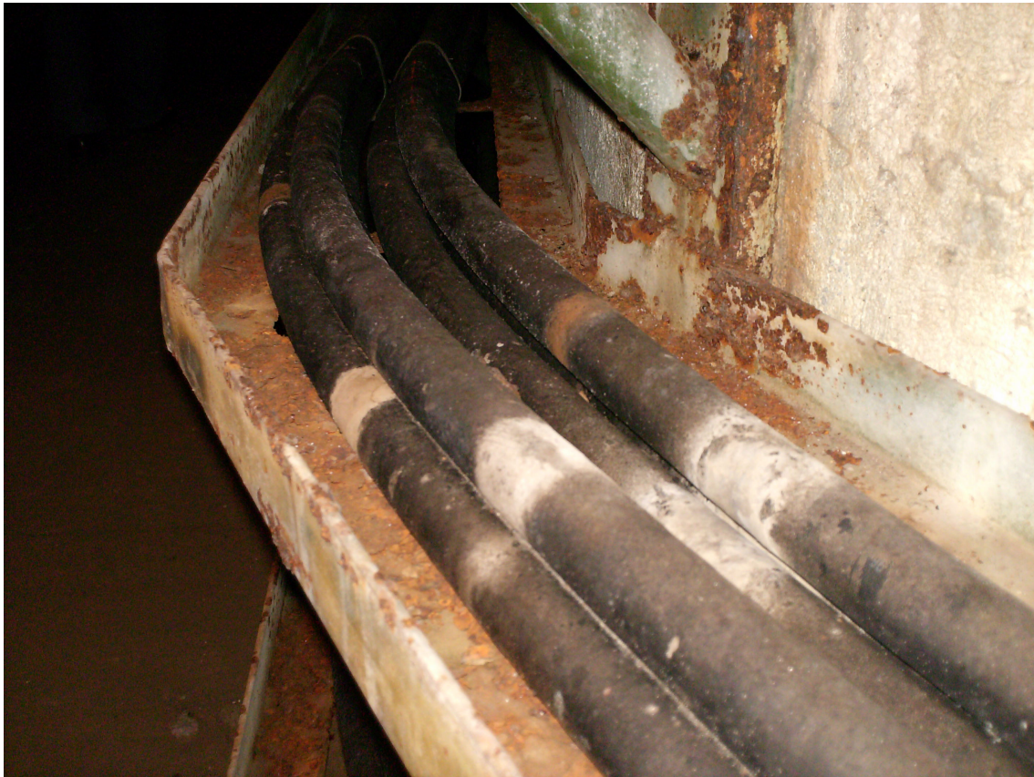
Figura 20. Cable de potencia
