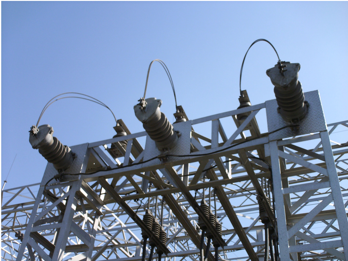
Figura 7. Barras salida transformador de servicios
