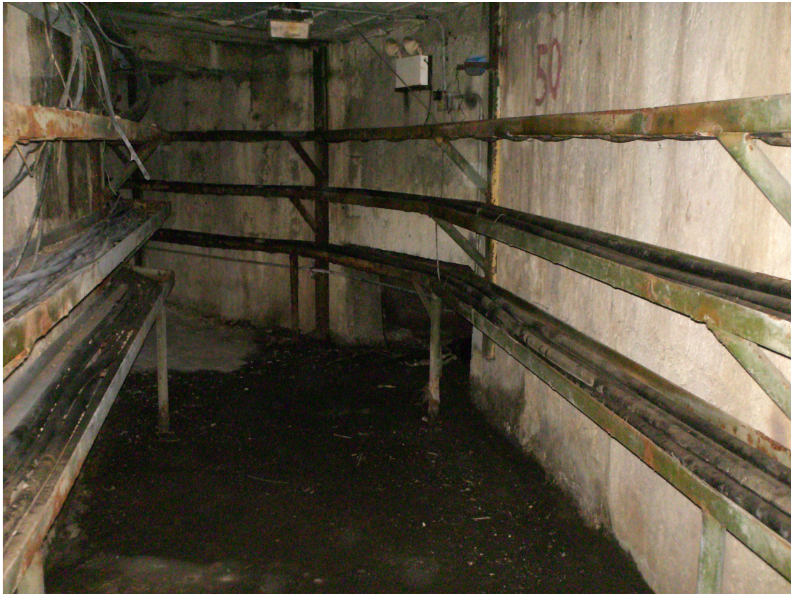
Figura 15. Canaletas en ducto subterráneo
