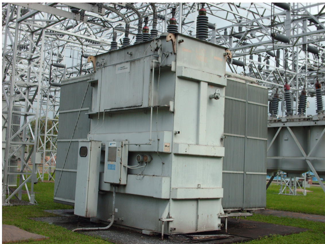
Figura 5. Transformador de 32 MVA
