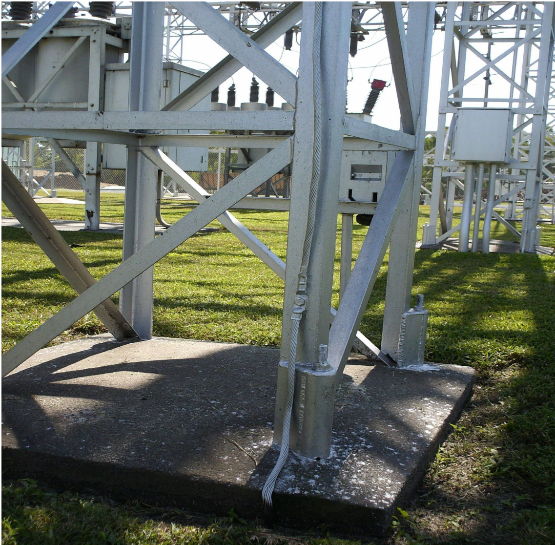
Figura 12. Descripción de tierras S/E 69 KV
