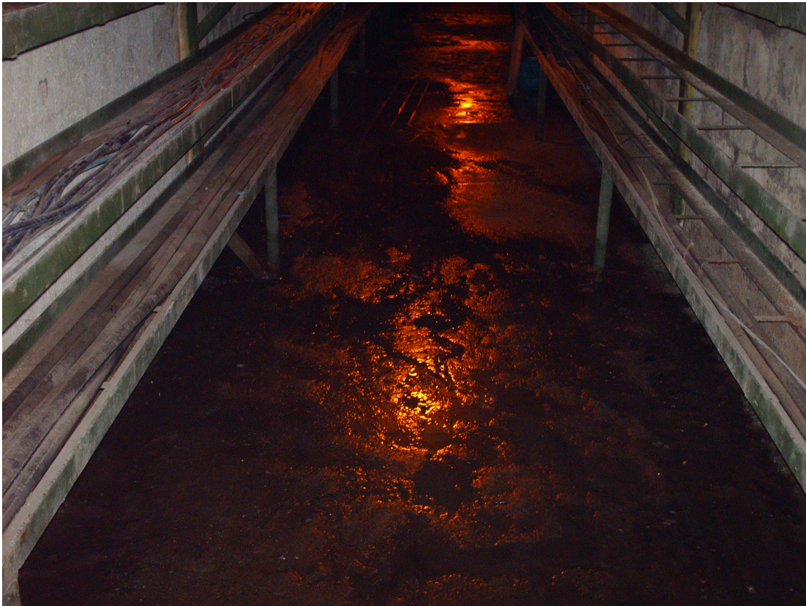
Figura 18. Canaletas en ducto subterráneo
