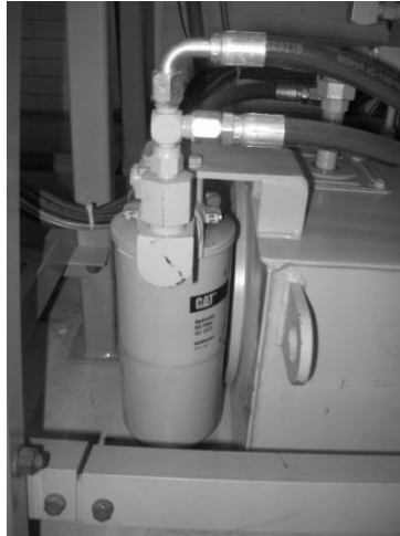
Figura 70. El filtro del sistema de potencia hidráulica
