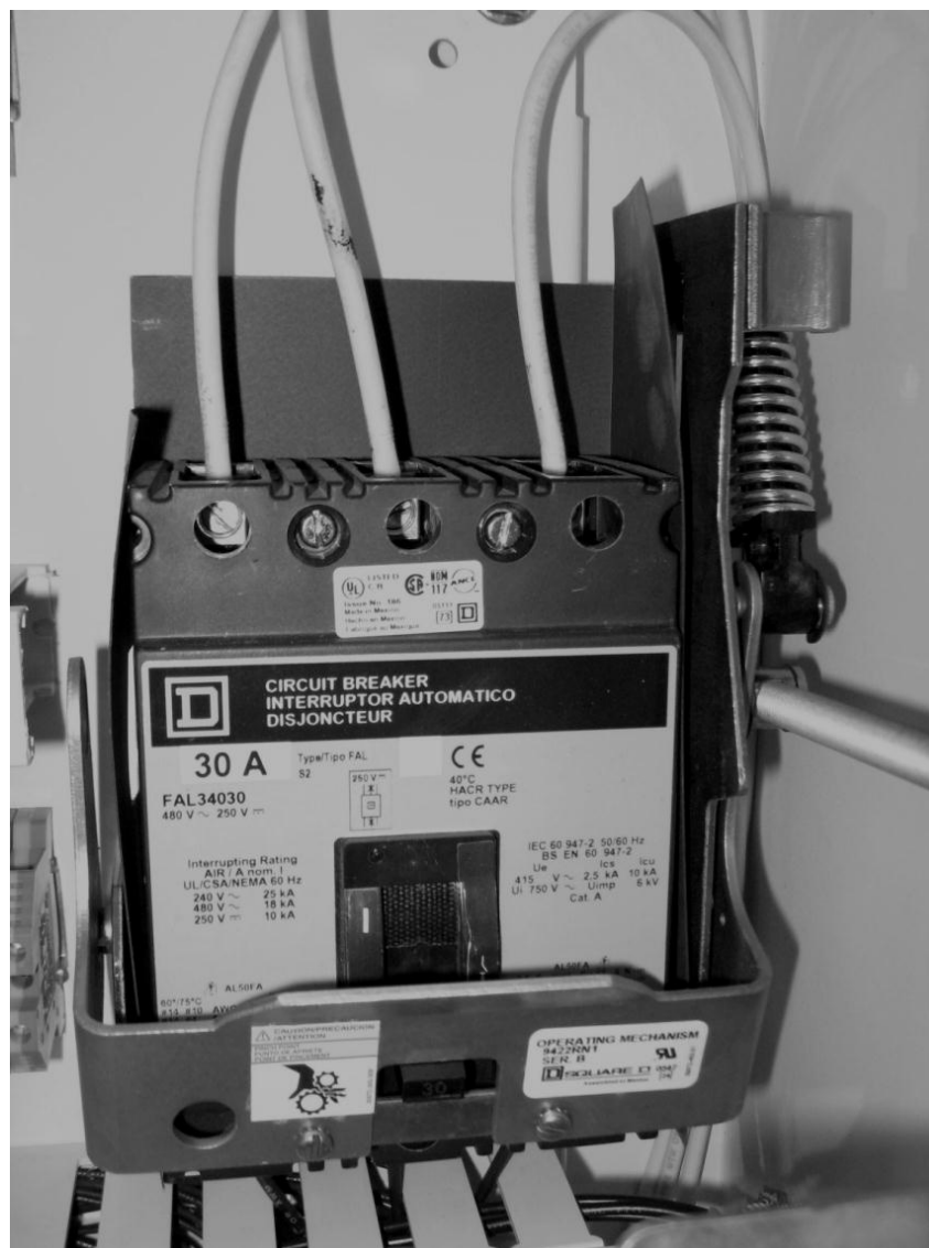
Figura 31. Conexión eléctrica en las terminales del banco
