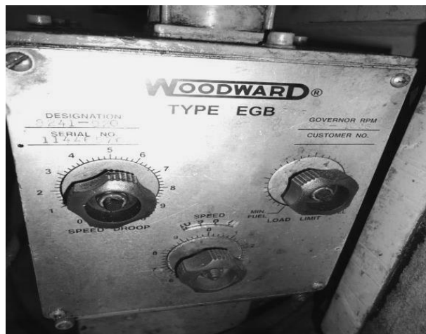
Figura 26. Actuador electrónico-mecánico motores Caterpillar 3616
