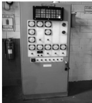
Figura 11. Panel local de motor Caterpillar 3616
