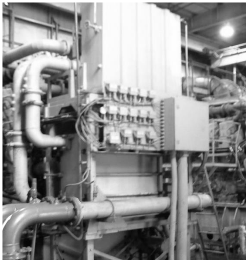
Figura 31. Intercambiador de calor y tanque de expansión
