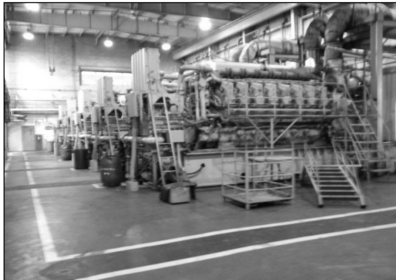
Figura 10. Motores Caterpillar 3616 instalados en CEE
