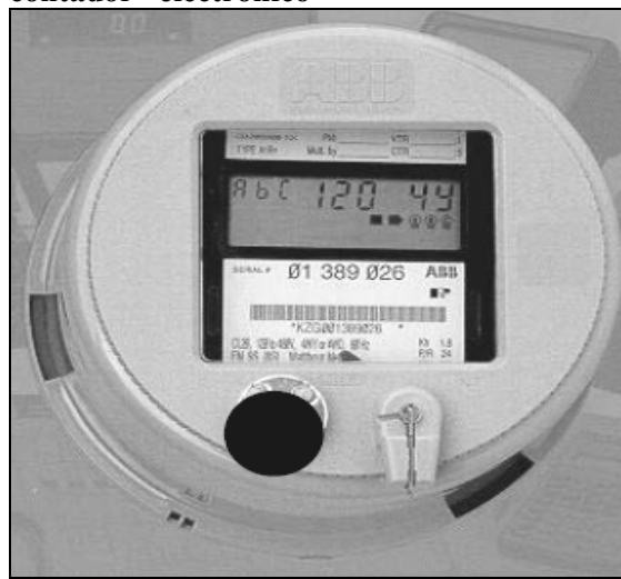
Figura 24. Medidor o “contador” electrónico
