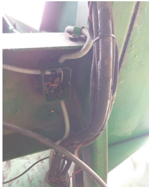
Figura 86. Caja central de conexiones de sensores
