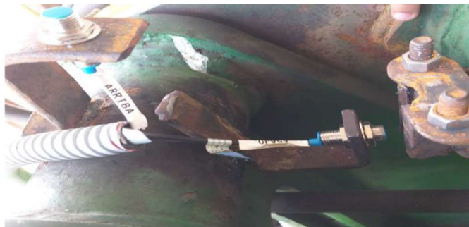
Figura 52. Instalación de sensores de efecto Hall en la pluma
