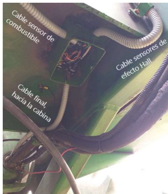
Figura 59. Caja central de sensores
