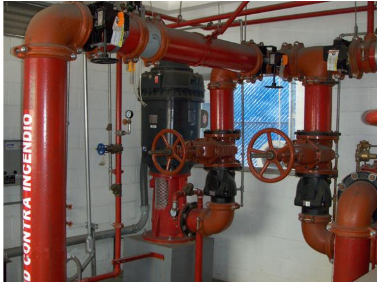
Figura 1. Tuberías en sistemas antincendios
