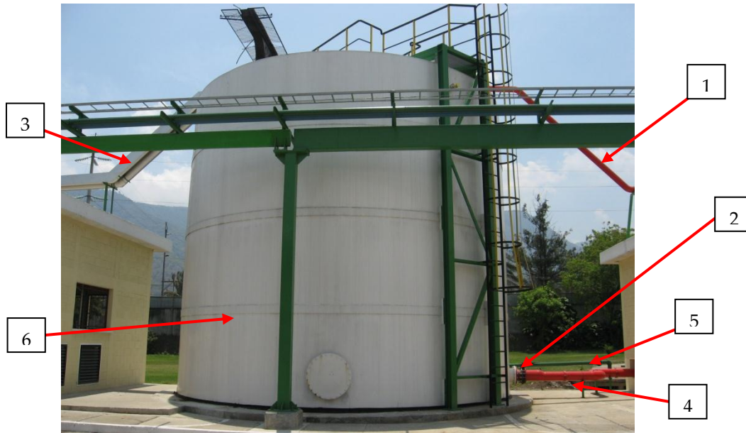
Figura 31. Tanque de agua antiincendios
