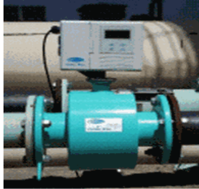
Figura 4. Medidor de flujo
