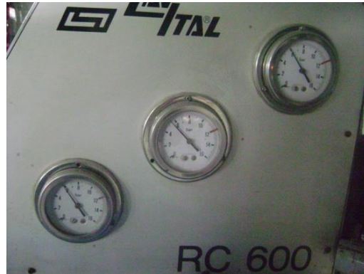
Figura 20. Instalación triple de instrumentos de medición
