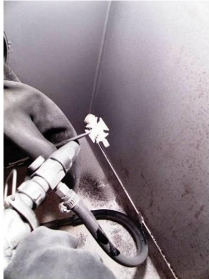
Figura 107. Interior de la cabina de arenado
