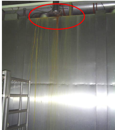
Fuga de vapor en HV-005, cocina de salchichas
