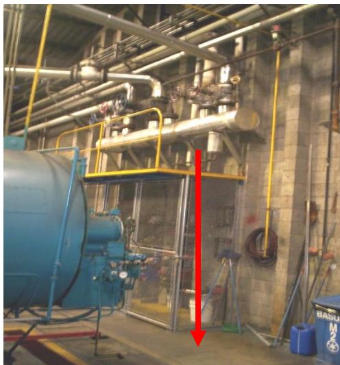
Figura 31. Manifold principal sin accesibilidad para su revisión
