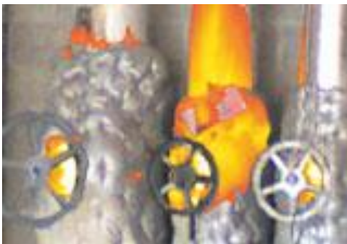
Imagen termografica a válvulas principales de distribución de vapor.
