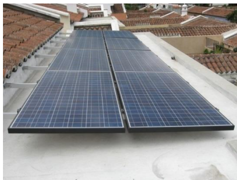
Figura 20. Conjunto de paneles solares
