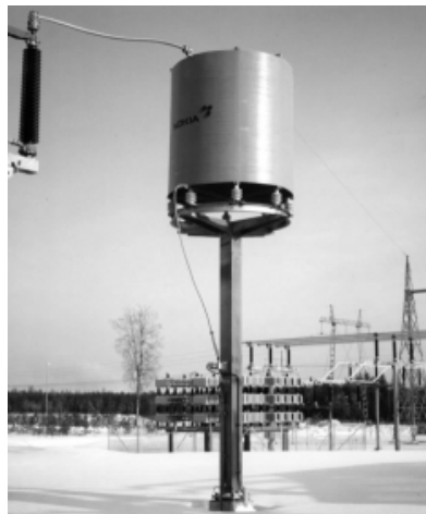
Figura 24. Reactor con núcleo de aire para puesta a tierra
