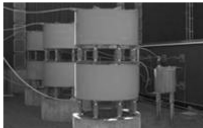
Figura 34. Reactores con núcleo de aire controlados por tiristores
