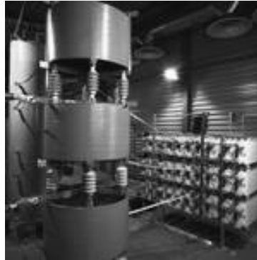
Figura 25. Reactores con núcleo de aire para filtros armónicos
