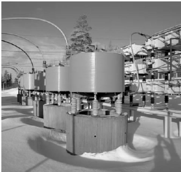
Figura 17. Reactores con núcleo de aire de compensación shunt
