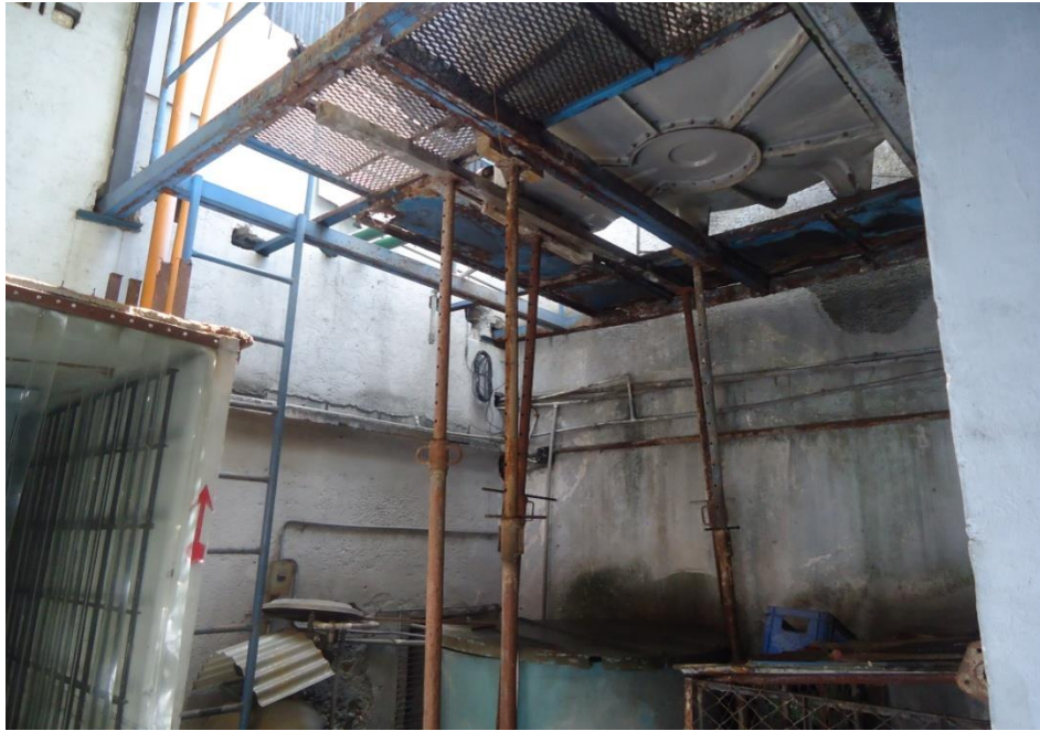
Figura 11. Condiciones de estructura de la torre de enfriamiento
