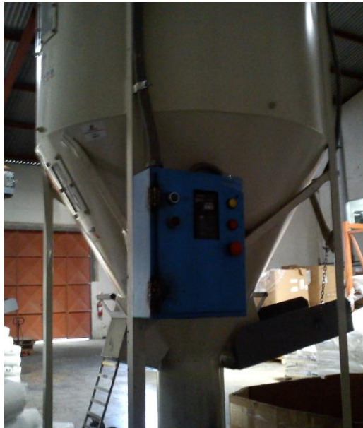
Figura 41. Variador de velocidad para mezcladora
