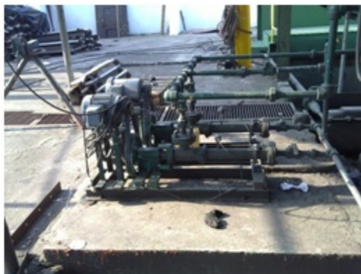
Figura 16. Bombas dosificadoras del polímero floculante
