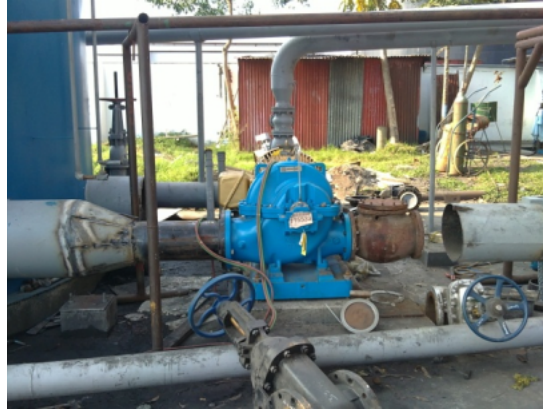
Figura 19. Bombas para agua limpia
