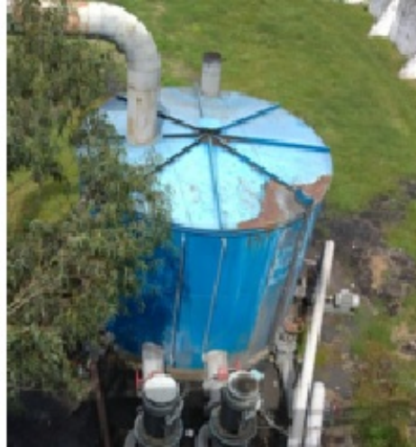
Figura 18. Tanque para agua tratada
