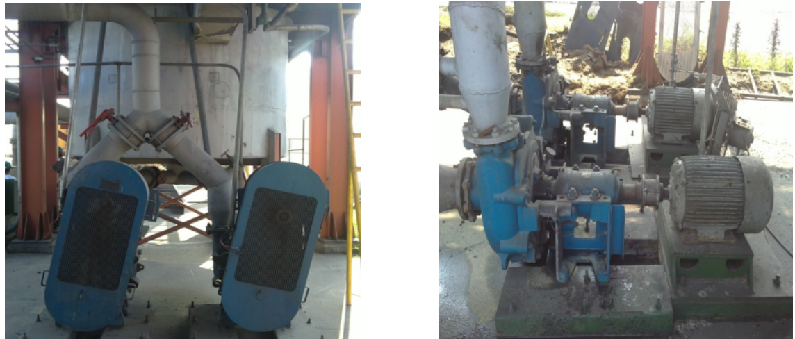
Figura 38. Bombas de lodos decantados
