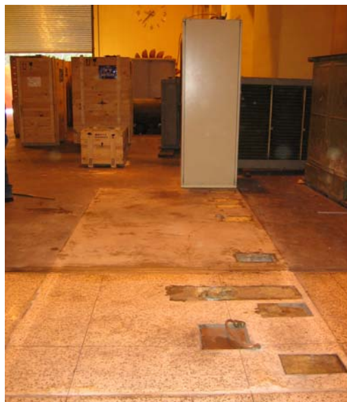
Figura 27. Espacio disponible para montaje de RAV 1111
