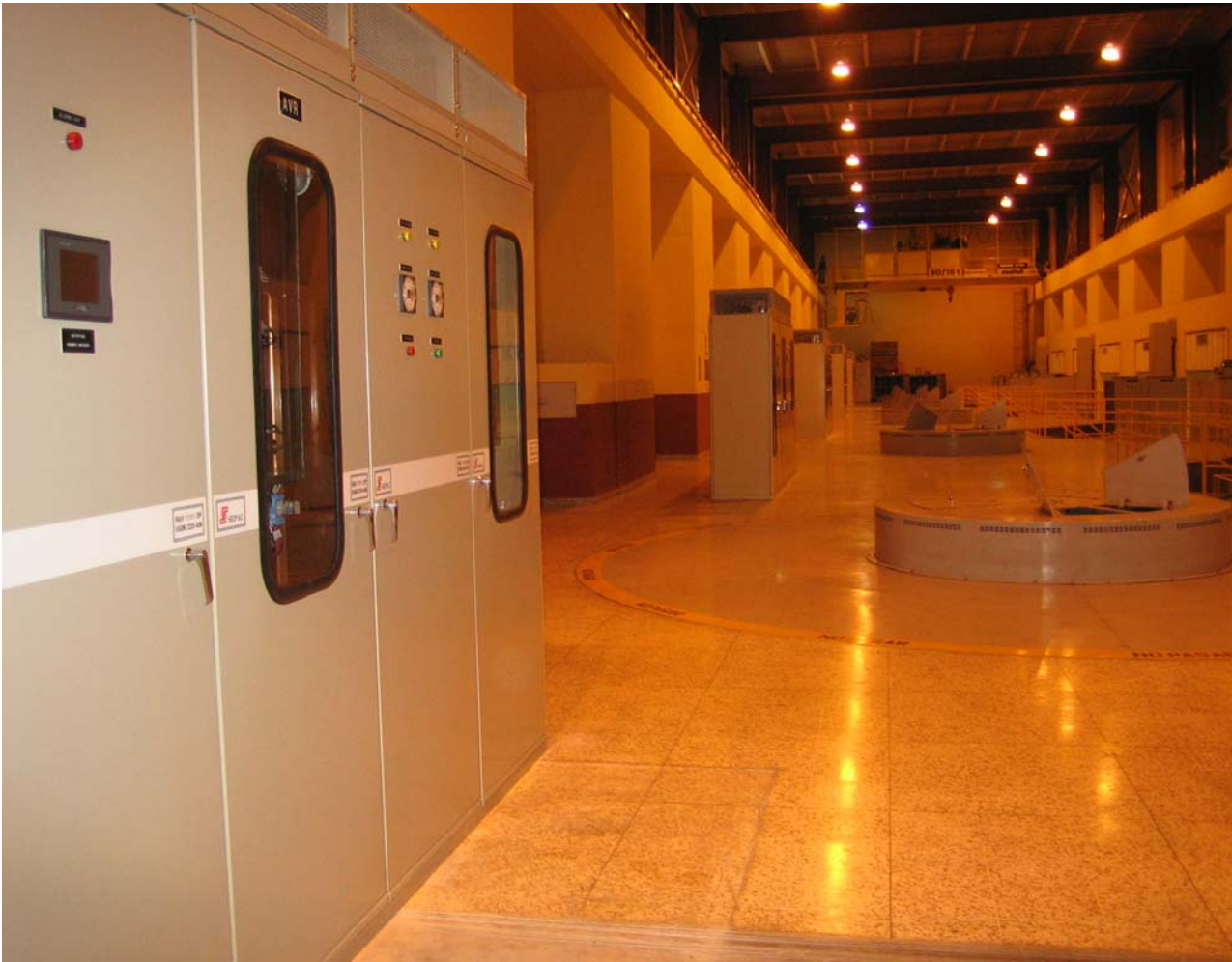
Figura 54. Cinco RAV 1111 2P 550K/220 funcionando en la C.H. Chixoy
