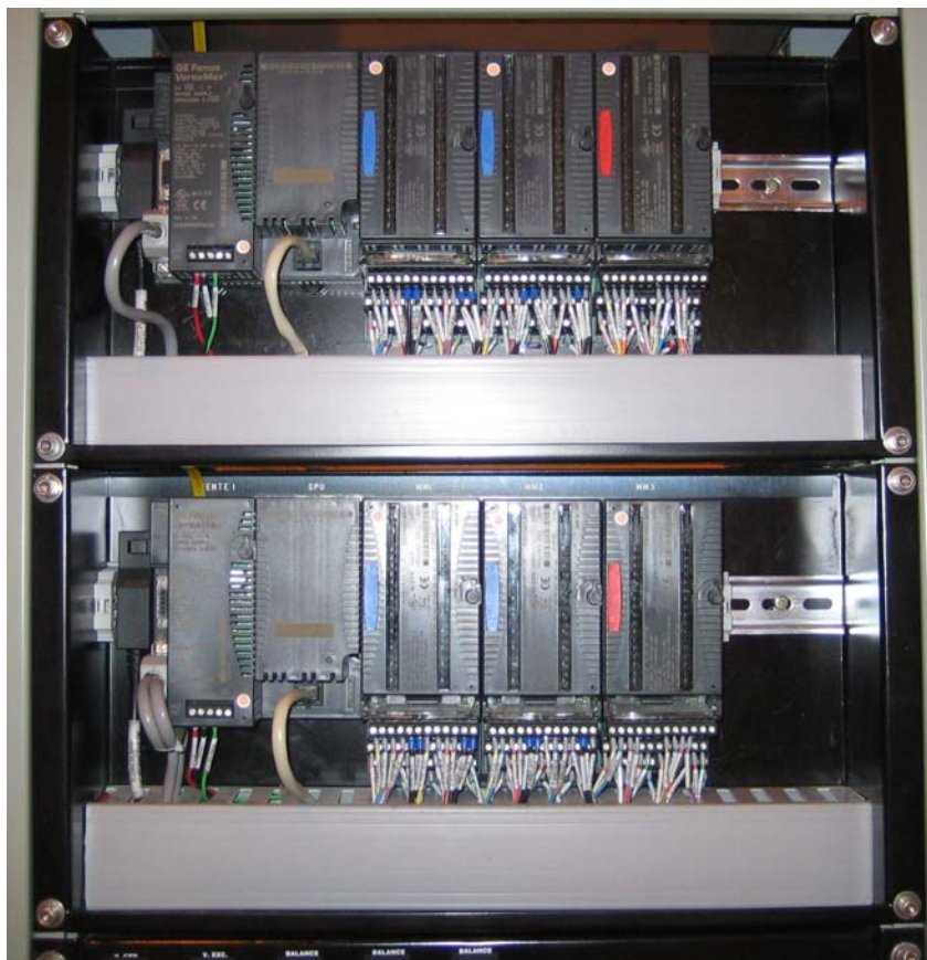
Figura 31. Rack UCEP y rack UCER con conexiones de control
