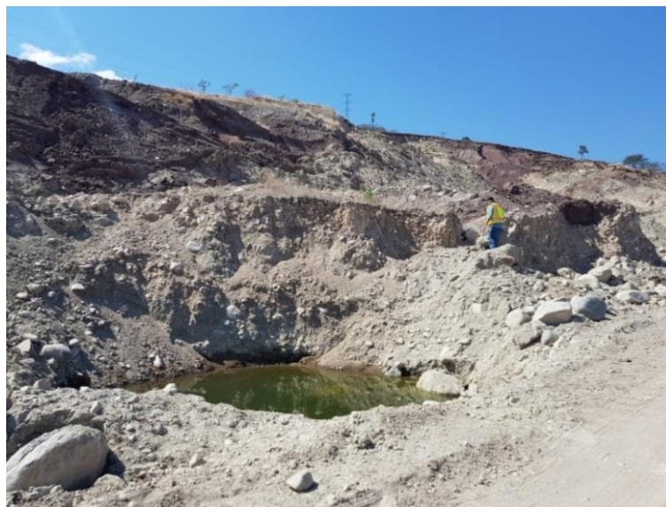
Figura 40. Agua acumulada km. 78+750
