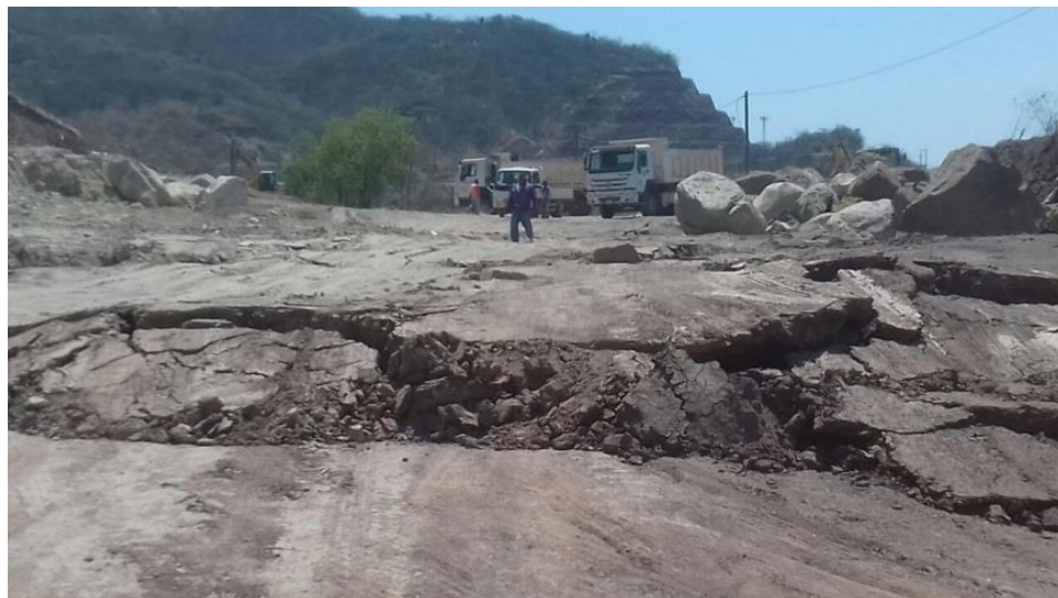
Figura 42. Expansión de arcillas km. 78+700
