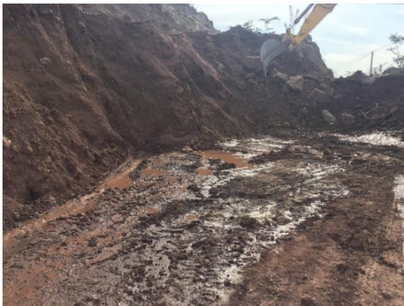
Figura 35. Evidencia del brote de agua en km 78+600
