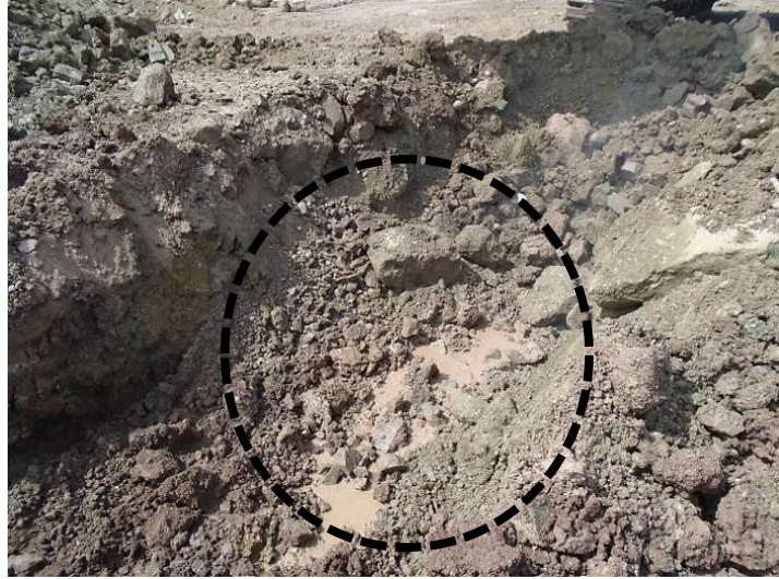
Figura 38. Brote de agua en km 78+600
