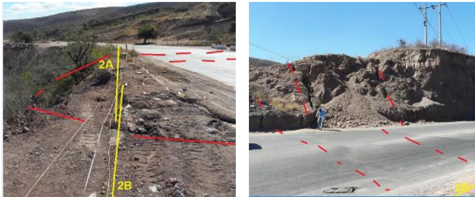
Figura 24. Bordes (inicio y fin) del área con movimientos constantes en proximidad a la carretera
