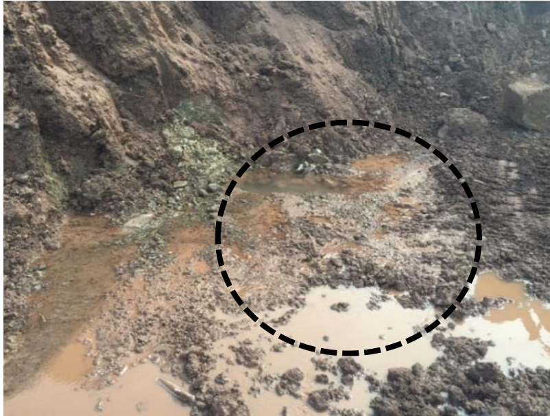
Figura 34. Evidencia del brote de agua en km 78+600
