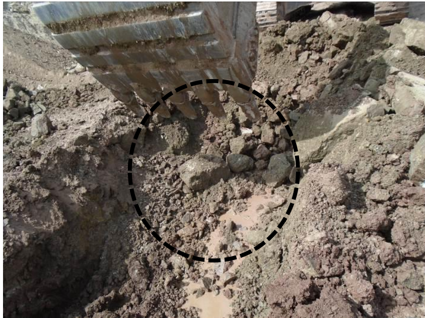
Figura 39. Brote de agua en km 78+600
