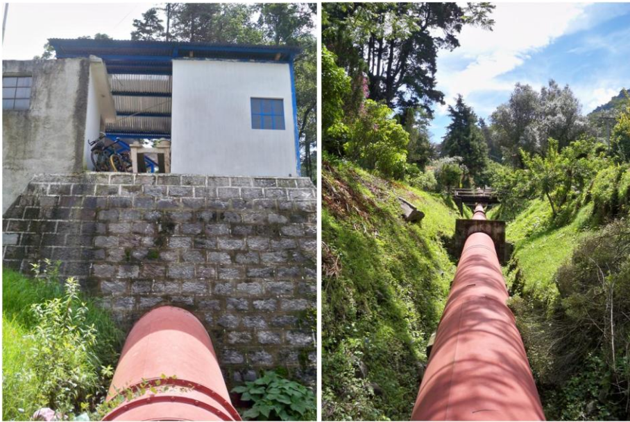
Figura 16. Tubería de presión
