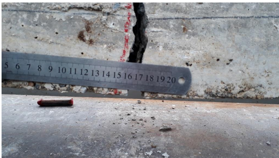
Figura 26. Medición de la grieta en el elemento viga por esfuerzo a flexión
