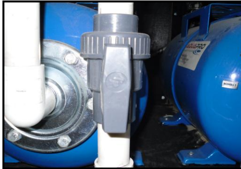
Figura 25. Válvula de paso, abierta
