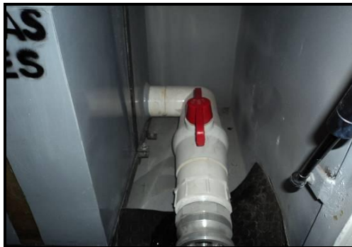
Figura 33. Tubería de descarga, abierta
