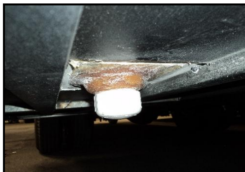
Figura 30. Tapón de fondo, depósito agua potable
