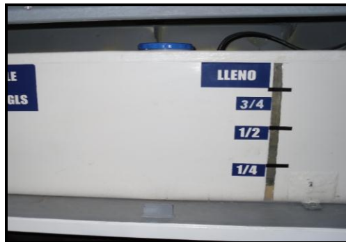
Figura 29. Depósito agua potable
