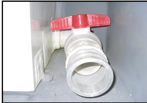
Figura 34. Tubería de descarga, cerrada
