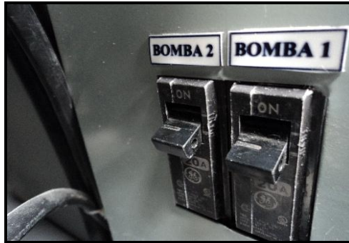
Figura 21. Flipon de bombas, off
