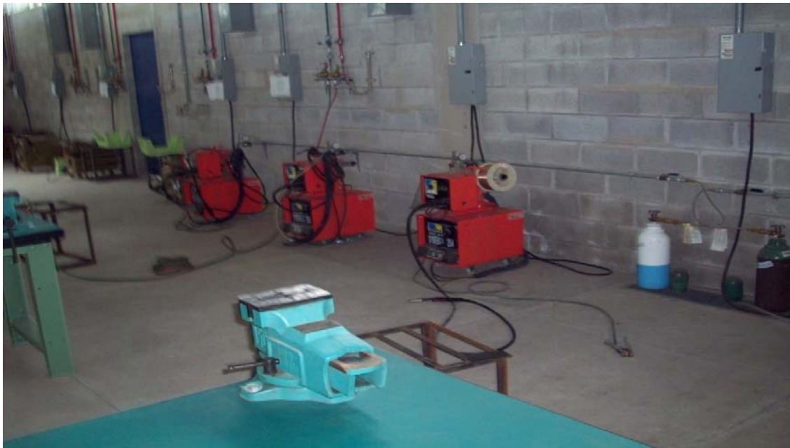
Parte de equipo de Mecánica
