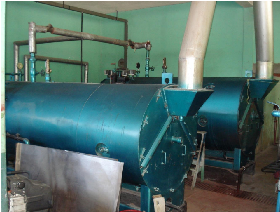
Figura 67. Cuarto de máquinas, Hospital Regional, Cobán Alta Verapaz
