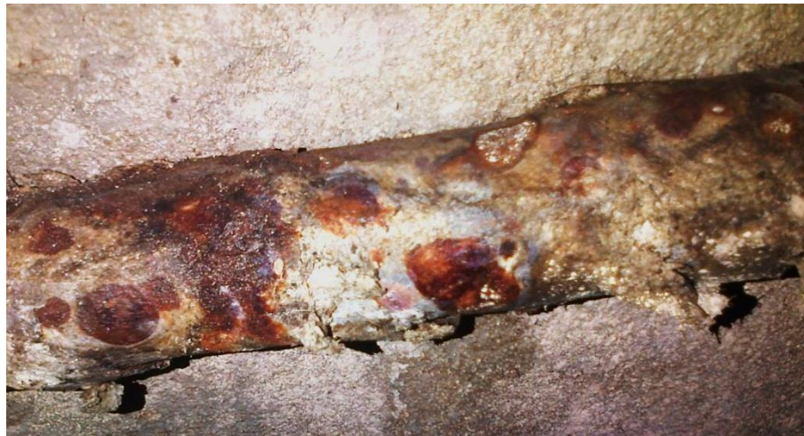
Figura 71. Tubería en mal estado
