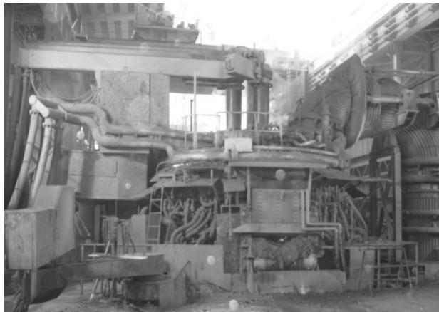
Figura 4. Horno de arco eléctrico
