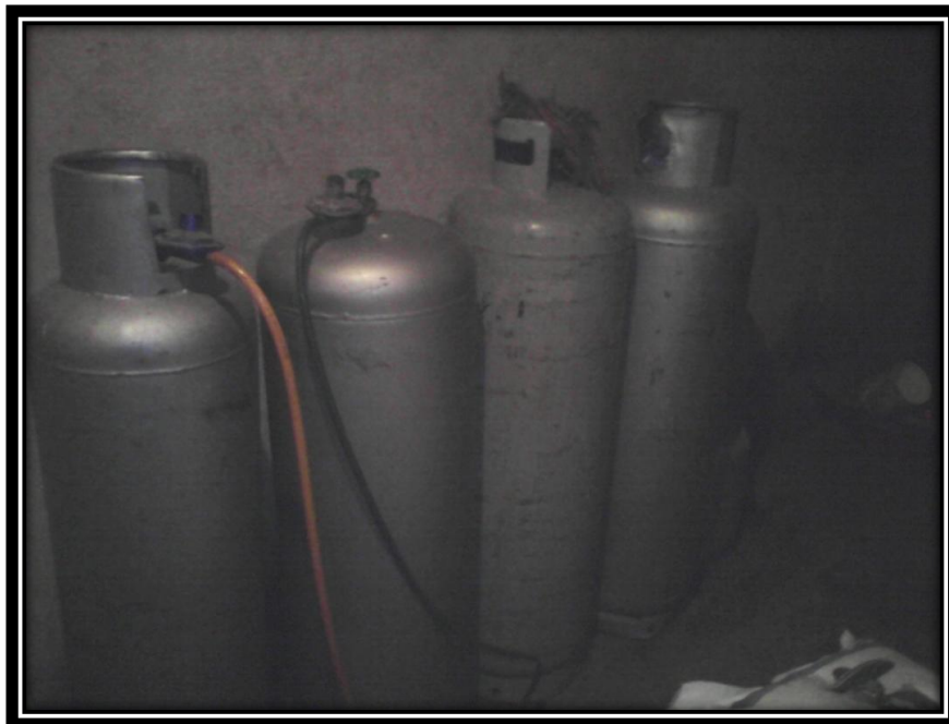
Figura 17. Área de suministro de gas
