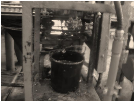
Figura 16. Ejemplo de falla en asfaltadora
