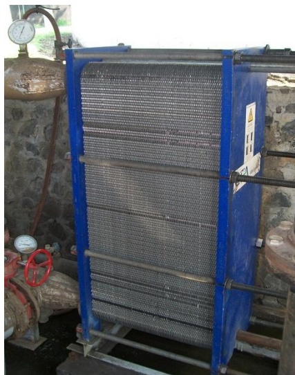
Figura 33. Intercambiador de calor tipo placas
