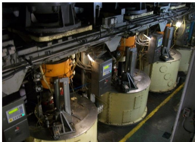
Figura 42. Batería de centrifugas
