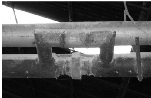
Figura 8. Conectores del circuito de calefacción de la tubería de transporte
