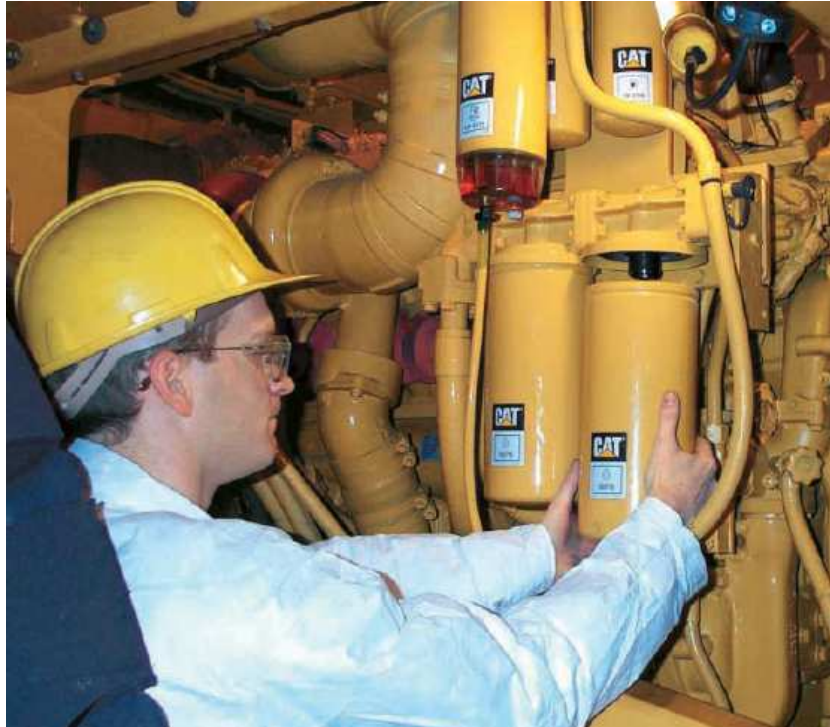
Figura 60. Rutina de mantenimiento preventivo
