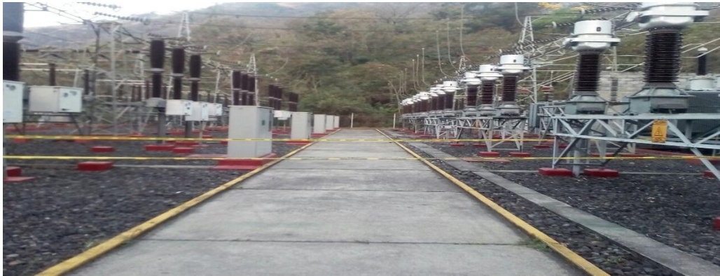
Figura 3. Subestación de potencia
