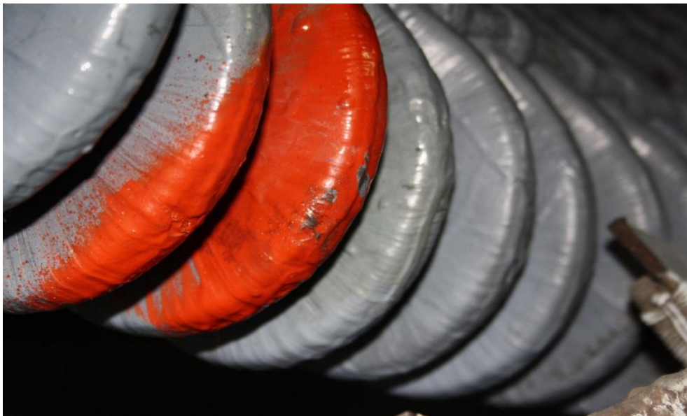
Figura 16. Bobinas recubiertas de pintura aislante roja
