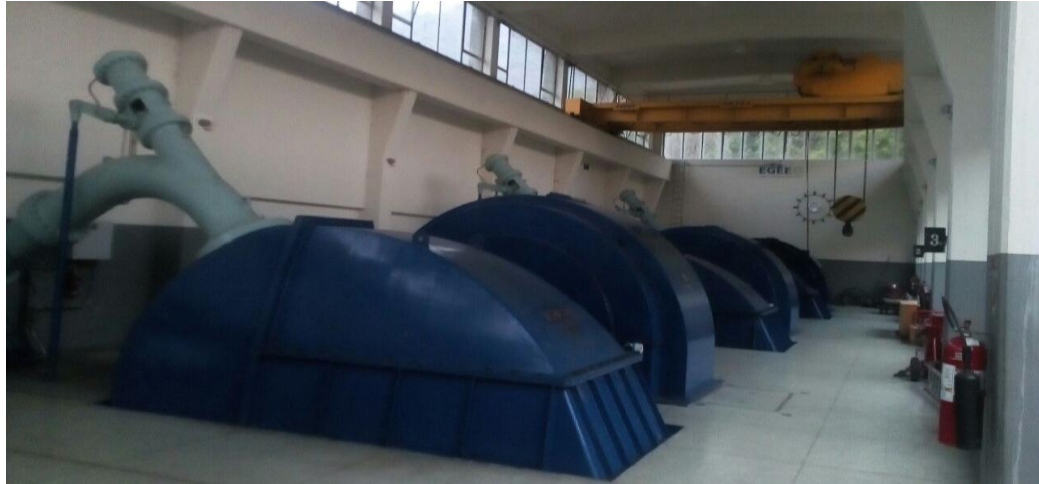
Figura 17. Generadores acoplados con turbina Pelton
