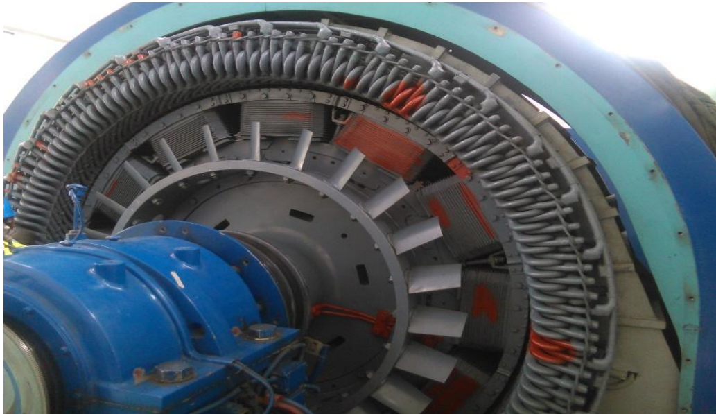
Figura 20. Vista interna del generador
