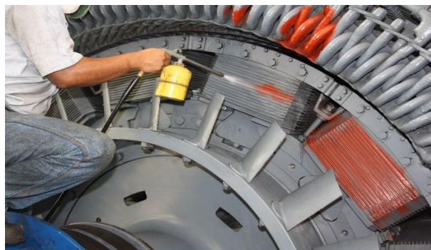
Figura 15. Limpieza de devanados del generador con dieltron
