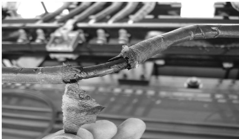
Figura 11. Papel kraft utilizado como aislante sólido en las barras de baja tensión
