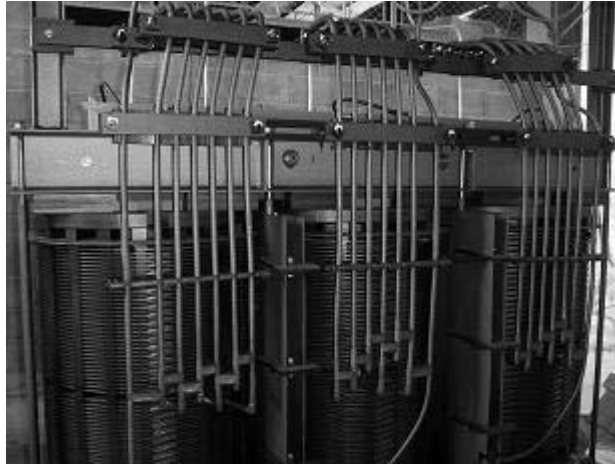
Figura 16. Bobinas de transformador de 5MVA 69/13.8KV
