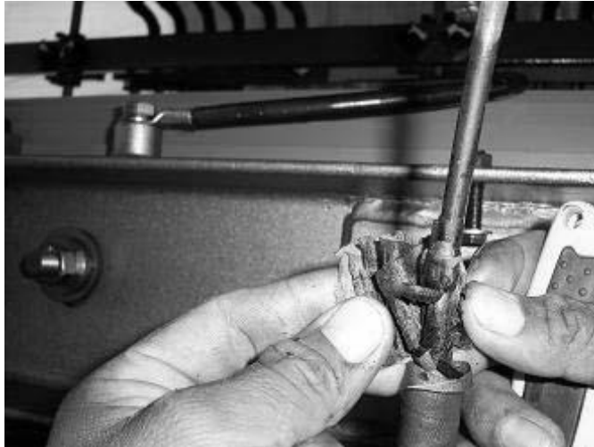
Figura 10. Daño en aislante sólido (papel kraft)
