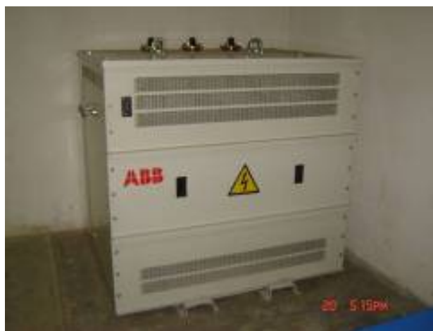
Figura 35. Transformador de sistemas auxiliares
