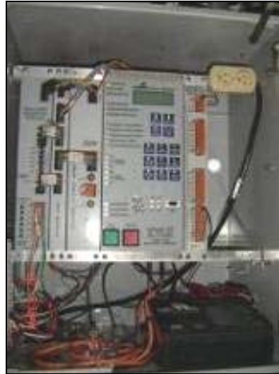
Figura 16. Gabinete y tablero de control COOPER
