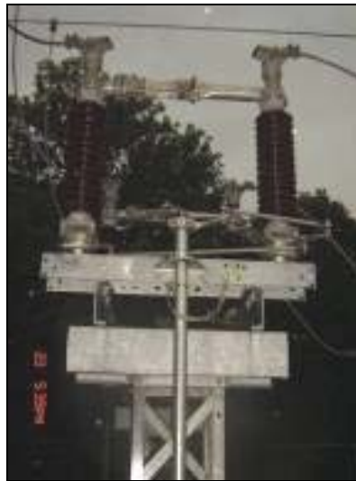
Figura 24. Seccionador horizontal doble apertura lateral
