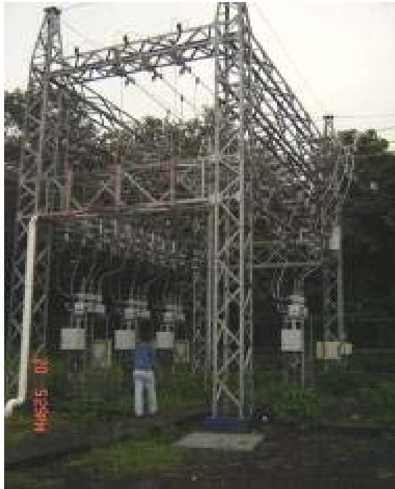
Figura 36. Protección por juego de fusibles transformador de SS AA
