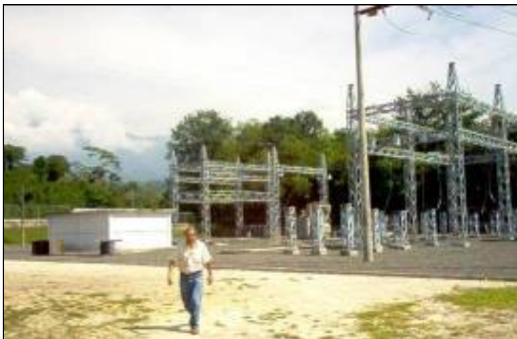
Figura 11. Subestación Chicacao 69/13.8 KV
