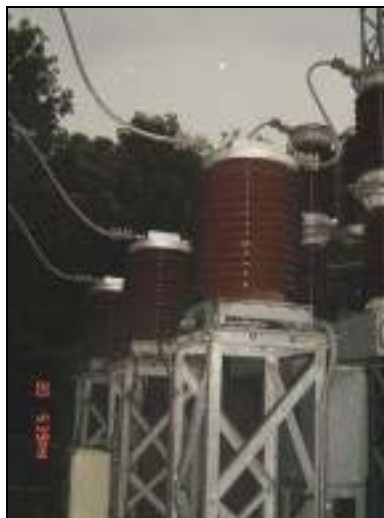
Figura 19. Transformador de corriente
