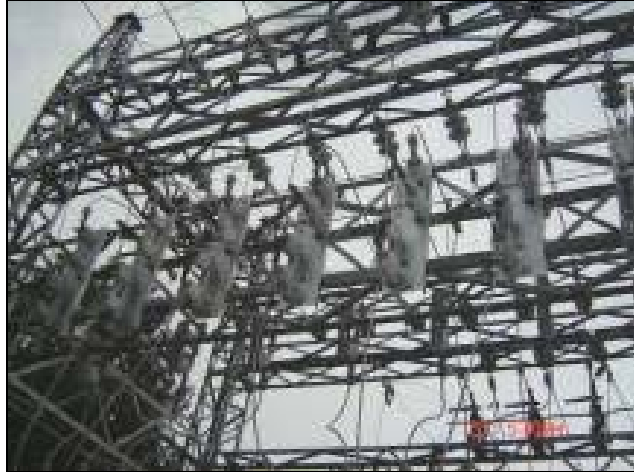
Figura 25. Seccionador vertical con apertura vertical
