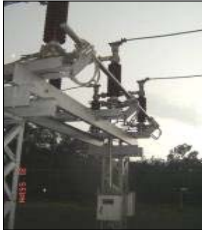
Fuente: Subestación Chicacao, junio 2009.
