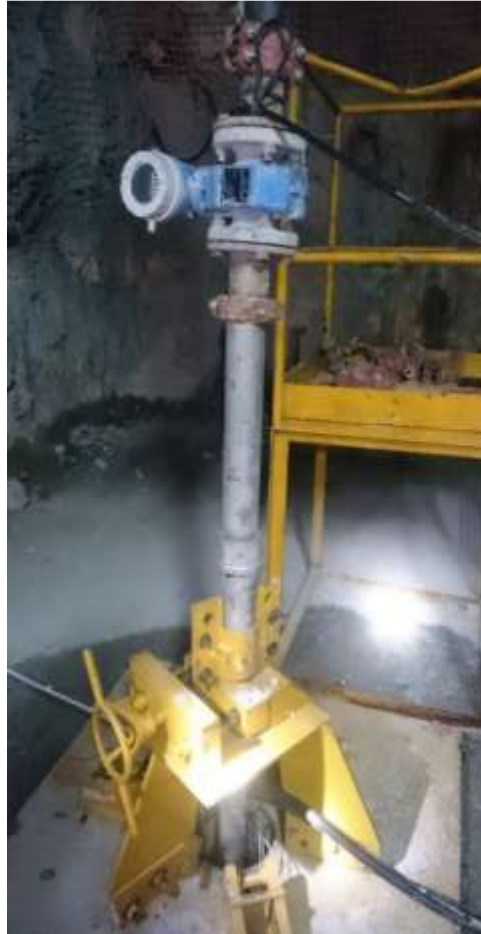
Figura 30. Pozo con flujómetro electromagnético instalado
