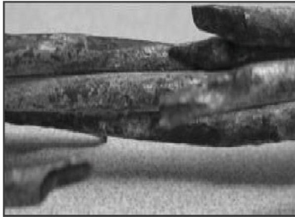
Figura 17. Cable de guarda fracturado
