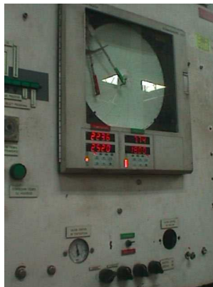
Figura 4. Tablero antiguo con Commander 1900
