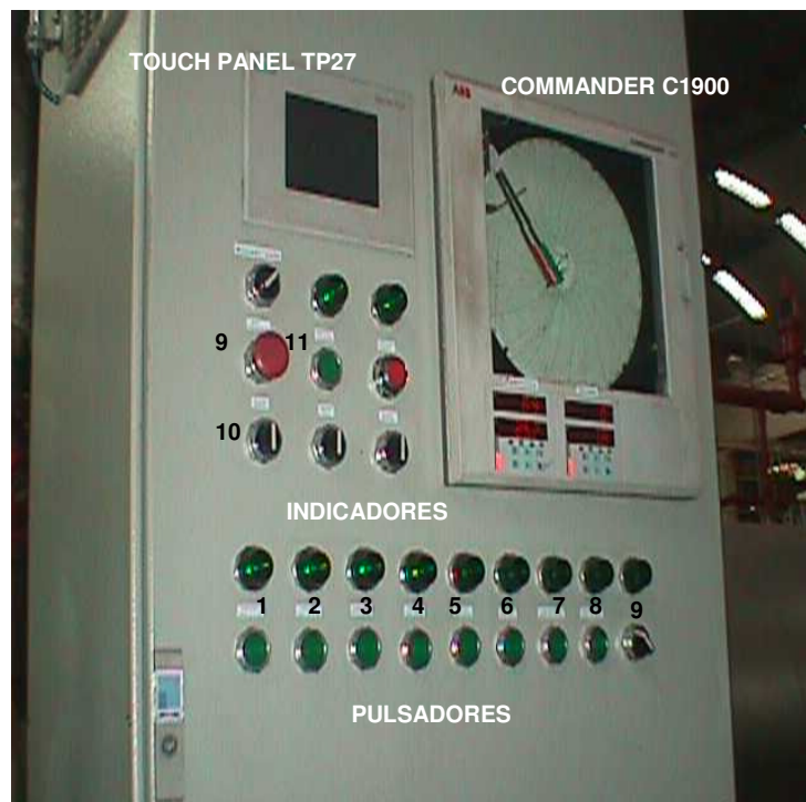
Figura 5. Tablero Modernizado con Comander y TP27 Touch Panel
