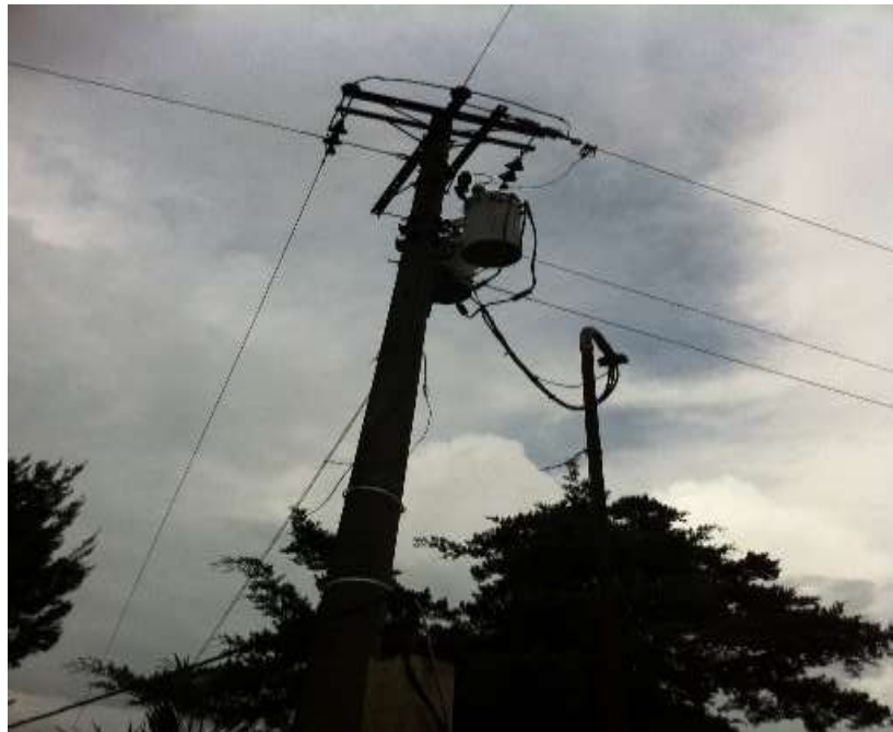
Figura 16. Poste de acometida eléctrica
