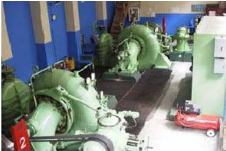
Figura 21. Sala de máquinas
