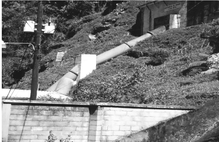
Figura 6. Tubería de carga
