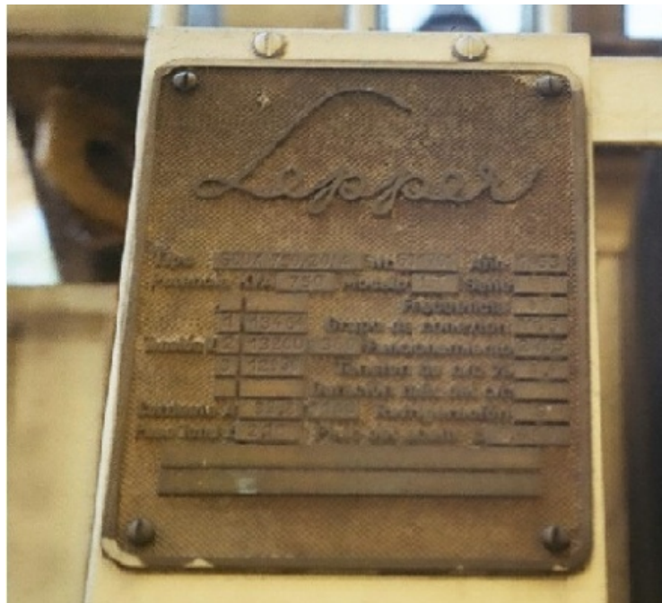
Fuente: Planta Hidroeléctrica Chichaic
