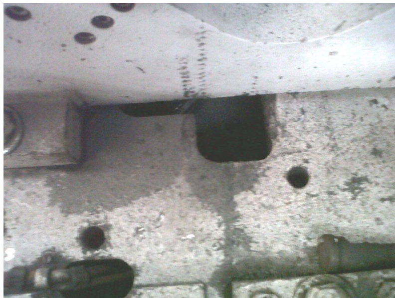
Figura 20. Partes de las máquinas con poca accesibilidad e iluminación
