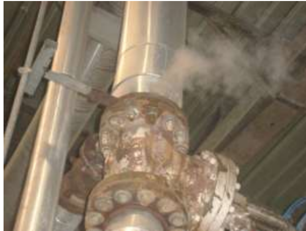
Figura 64. Válvula con fuga de vapor
