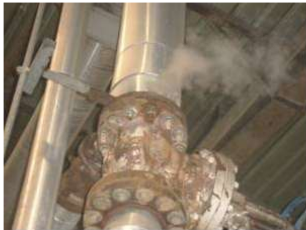
Figura 77. Fuga de vapor en flange
