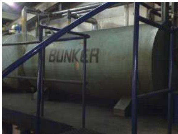
Figura 47. Tanque diario de bunker
