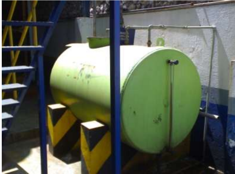
Figura 50. Tanque de diésel tres mil galones
