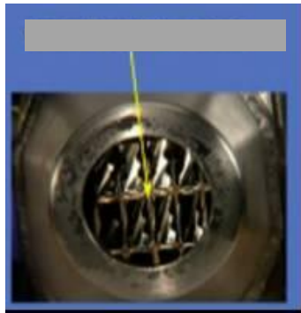
Figura 162. Generadores de turbulencia dentro del enfriador
