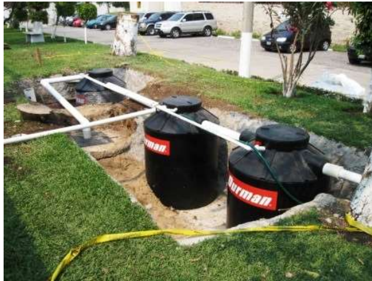
Figura G. Planta de lodos activados piloto instalada
