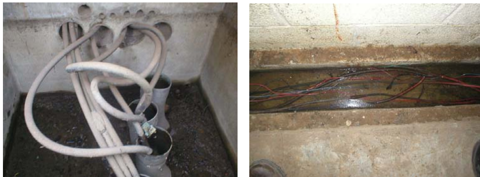
Figura 34. Cajas de registro en piso
