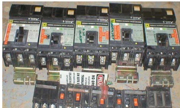
Figura 33. interruptores termomagneticos dañados
