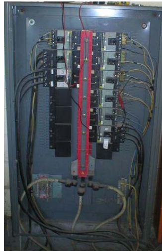
Figura 36. Tablero de Distribución con alimentación inferior
