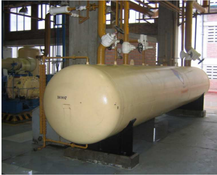
Figura 82. Tanque de líquido de refrigerante amoniacaco, con punto de purga
