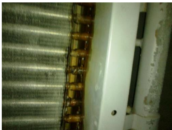
Figura 123. Fugas en el serpentín
