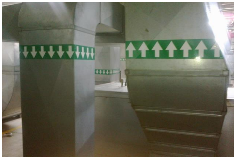
Figura 34. Señalización de ductos
