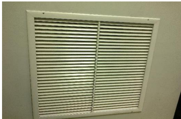
Figura 93. Rejilla de extracción
