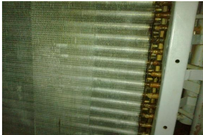
Figura 40. Fugas en el serpentín
