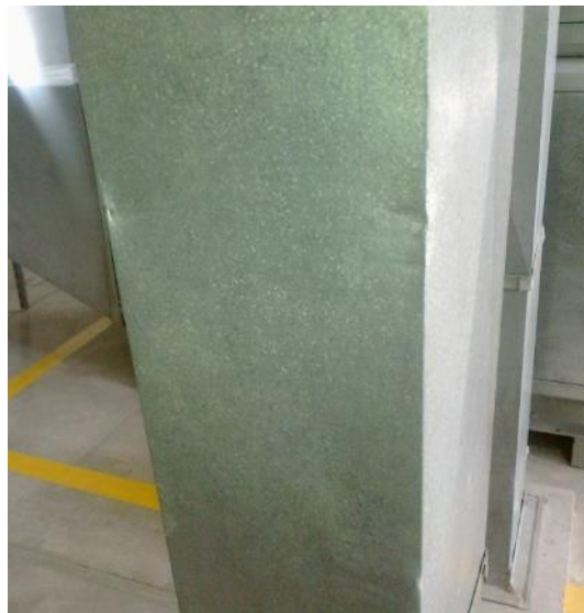
Figura 36. Golpes en el ducto
