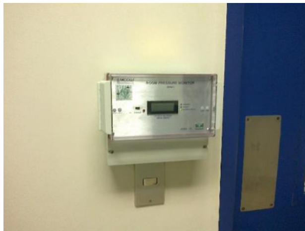
Figura 96. Monitor de presión diferencial (I)
