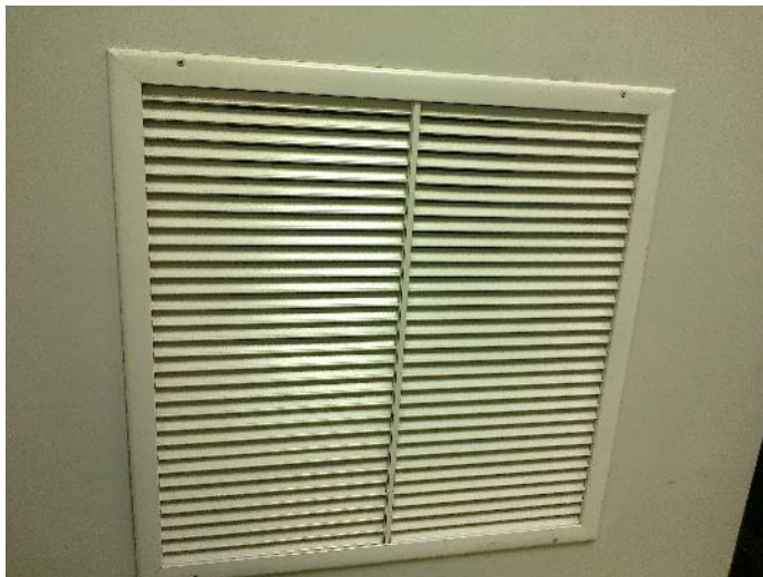
Figura 29. Rejilla de extracción
