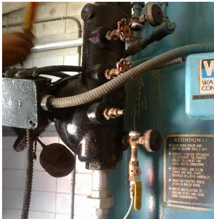
Figura 129. Control de agua bajo limpieza
