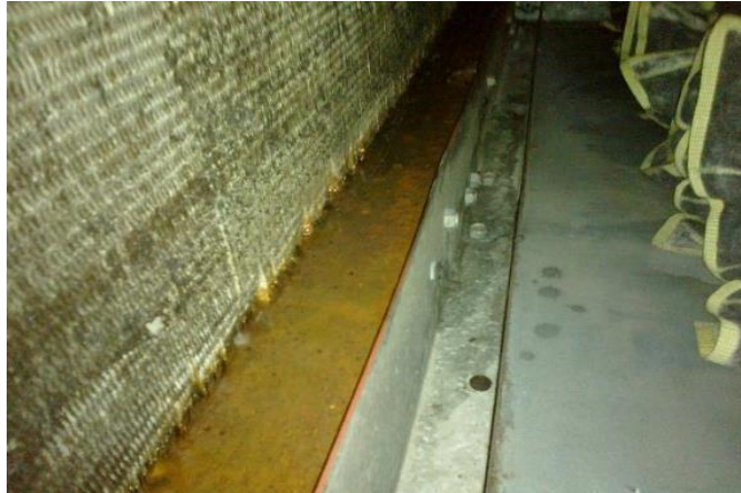
Figura 39. Óxido en el serpentín
