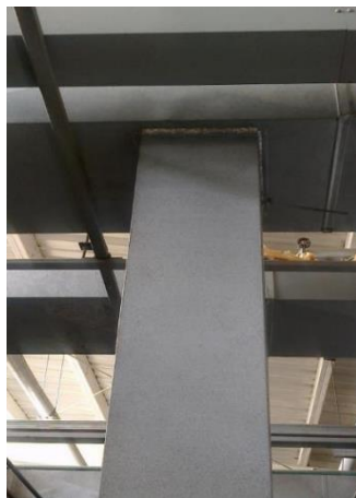
Figura 38. Sellador en mal estado
