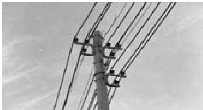
Figura 34. Referente al menor número de circuitos y mejor aspecto visual empleando conductor protegido
