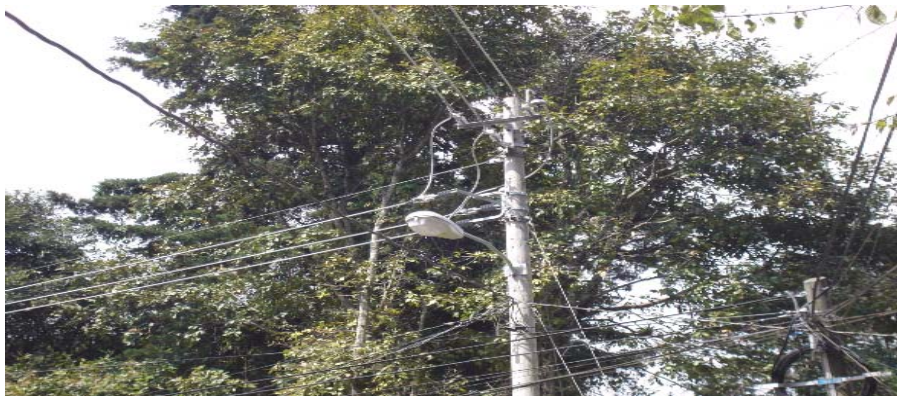
Figura 31. Mejor ordenamiento en las líneas de distribución empleando conductor protegido
