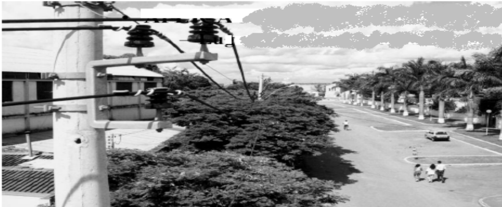
Figura 30. Mejor aspecto visual de la línea de distribución empleando conductor protegido
