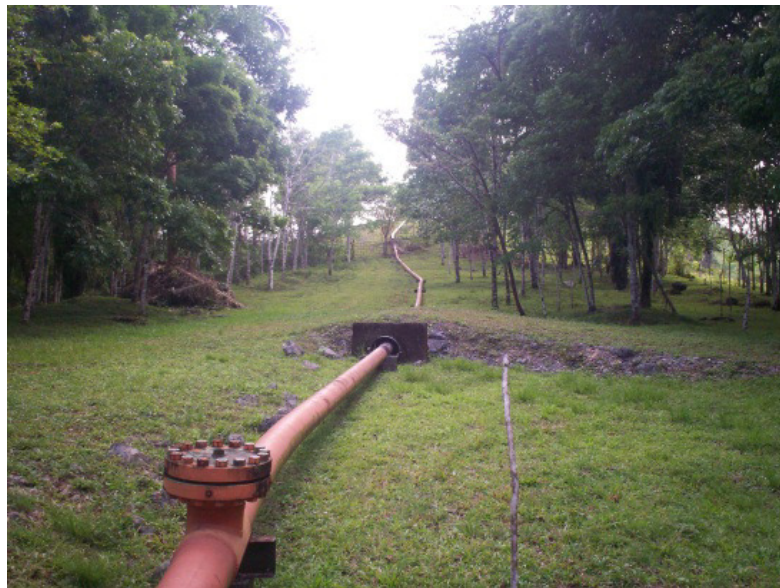
Figura 6. Tubería de 10 pulgadas
