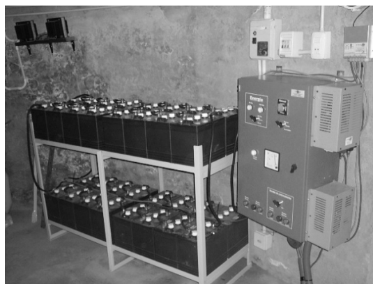
Figura 28. Banco de baterías
