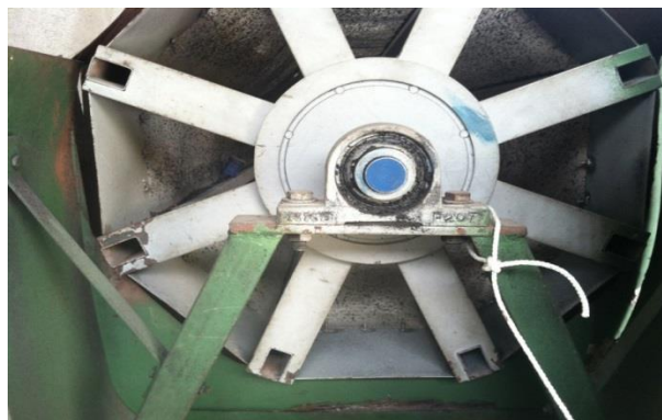
Figura 24. Vista de chumacera para rotación de eje central
