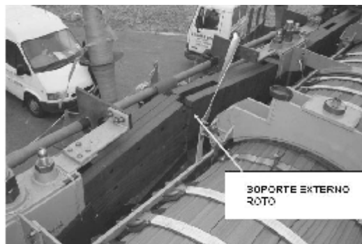
Figura 98. Falla de montaje
